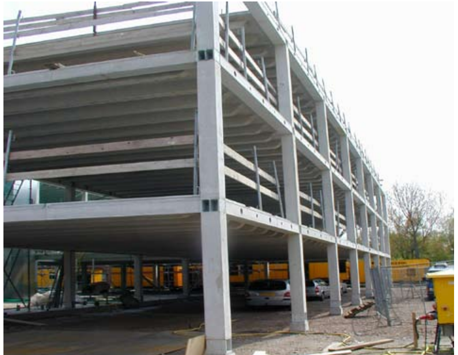
Lo scheletro di un edificio smontabile in Olanda. Per gentile concessione di BFBN.
